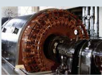
Turbogenerator im Kraftwerk Karnapp in Essen in den 60ern.
